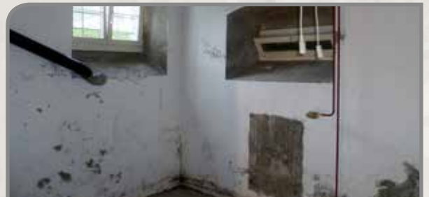
Unbrauchbarer Raum durch feuchte Mauern und muffige Luft
